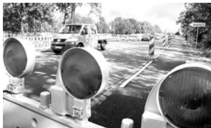
Durchfahrt gesperrt: Ab kommendem Montag müssen sich die Autofahrer auf der Ritterhuder Heerstraße für drei Tage wieder auf Staus einstellen. Aufgrund von Rissen in der Fahrbahn muss die Straße saniert werden. FOTO: VALEK
